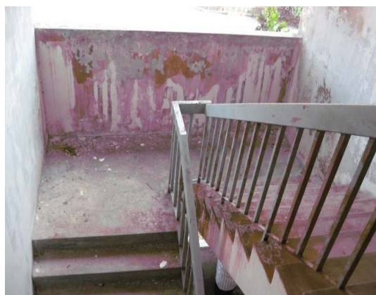
Gambar 5.7 Keadaan Cat Yang Pudar Dan Terkopak Di Dinding Flat Kwarters
