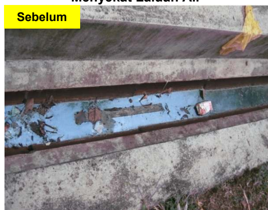
Gambar 5.5 Longkang Yang Kotor Menyekat Laluan Air
