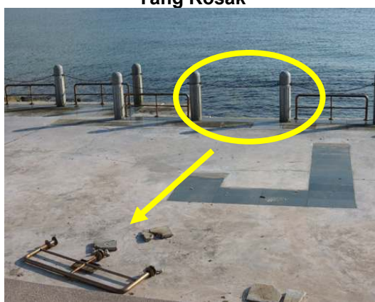
Gambar 3.16 Keadaan Penghadang Keselamatan Yang Rosak
