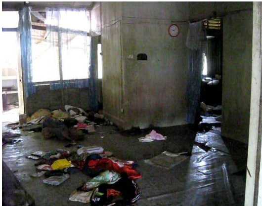
Gambar 5.14 Kuarters Rosak Yang Tidak Disenggara
