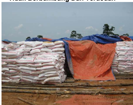
Gambar 6.3 Baja Dibiarkan Di Kawasan Yang Tidak Berbumbung Dan Terdedah
