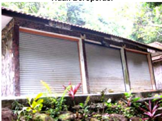
Gambar 3.10 Bangunan Kedai Yang Tidak Beroperasi
