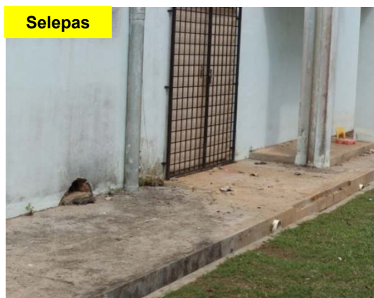
Gambar 5.4 Longkang Yang Telah Disenggara
