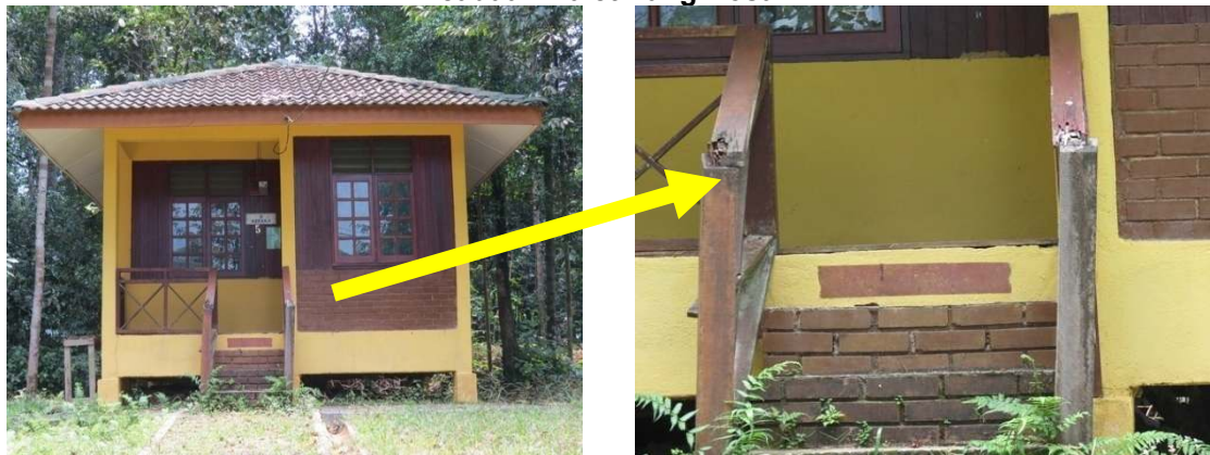
Gambar 3.25 Keadaan Calet Yang Rosak
