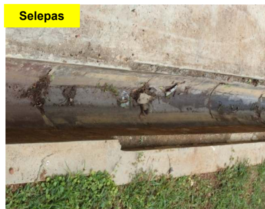
Gambar 5.6 Longkang Yang Telah Disenggara
